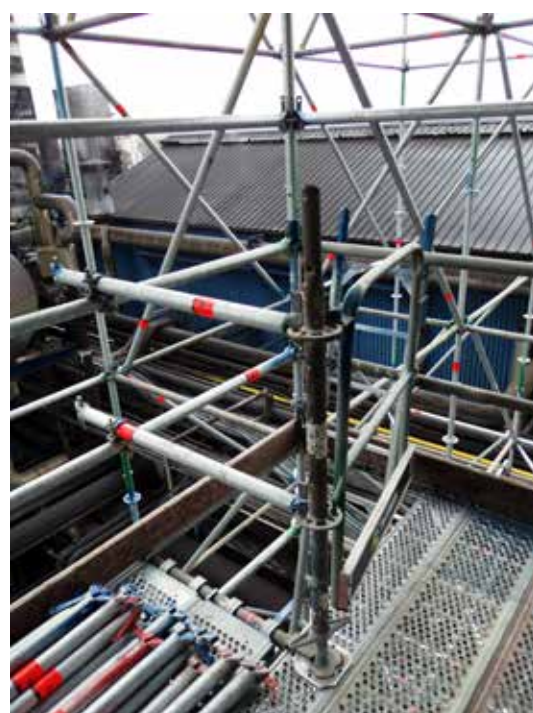
Figure 36 : échelle passerelle intégrée avec un portique de sécurité
