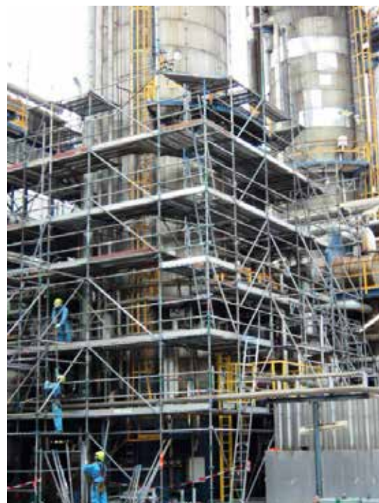
Figure 35 : Échelle passerelle intégrée
