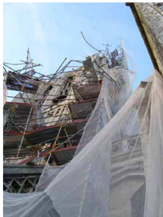
Figure 51 : Conséquences d'un mauvais ancrage
